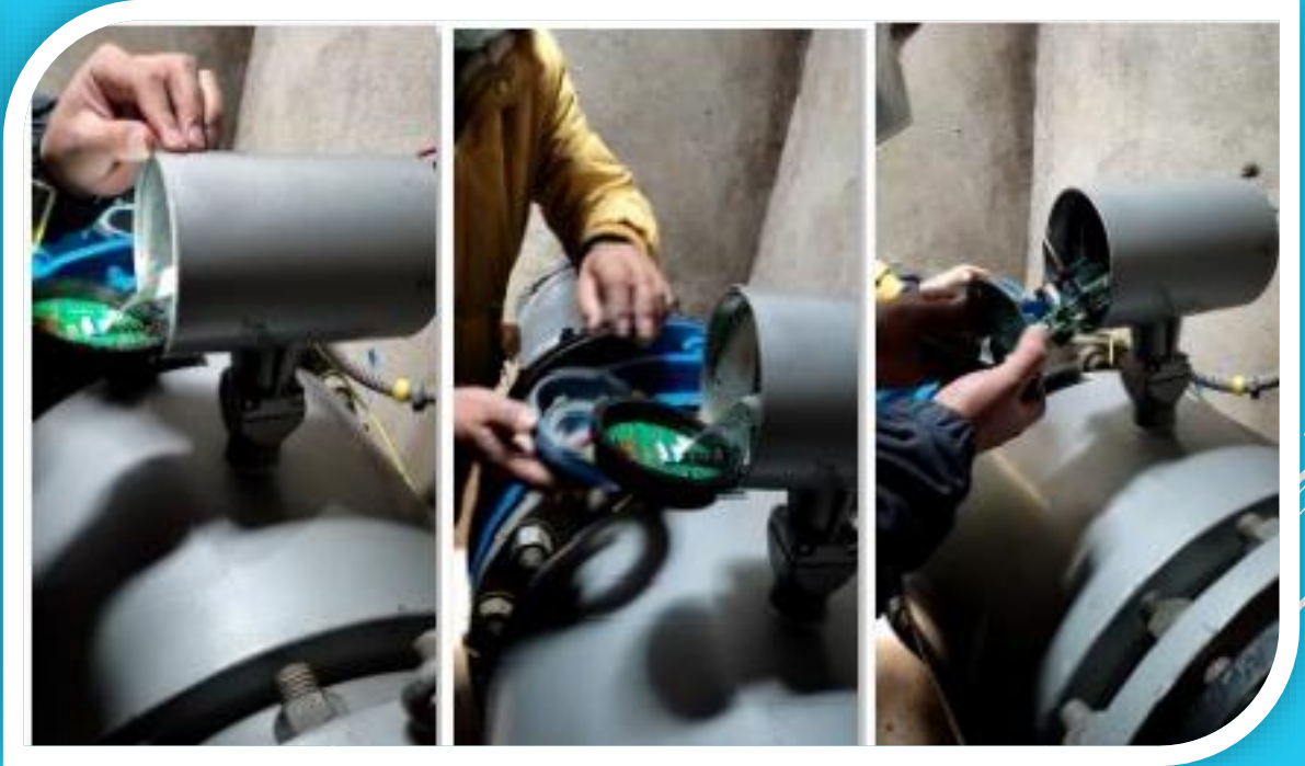
MANTENIMIENTO DE MACROMEDIDOR DE LA LÍNEA DE CONDUCCIÓN CR1- PICHASANI Y AL TABLERO ELÉCTRICO DE CR1 PARA CONECTAR A UPS
